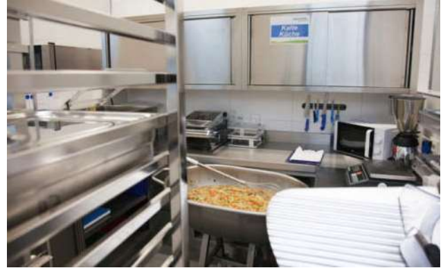
Die Kochbereiche sind vorbildlich voneinander getrennt und nehmen auf spezielle Bedürfnisse, wie niedrigere Arbeitshöhen, Rücksicht.
